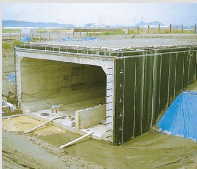
県道地下道拡張工事徳島空港 施 主 第三港湾建設局 所 在 地 徳島県板野郡 施工面積 2,800m 2 施工年月日 S58.2
